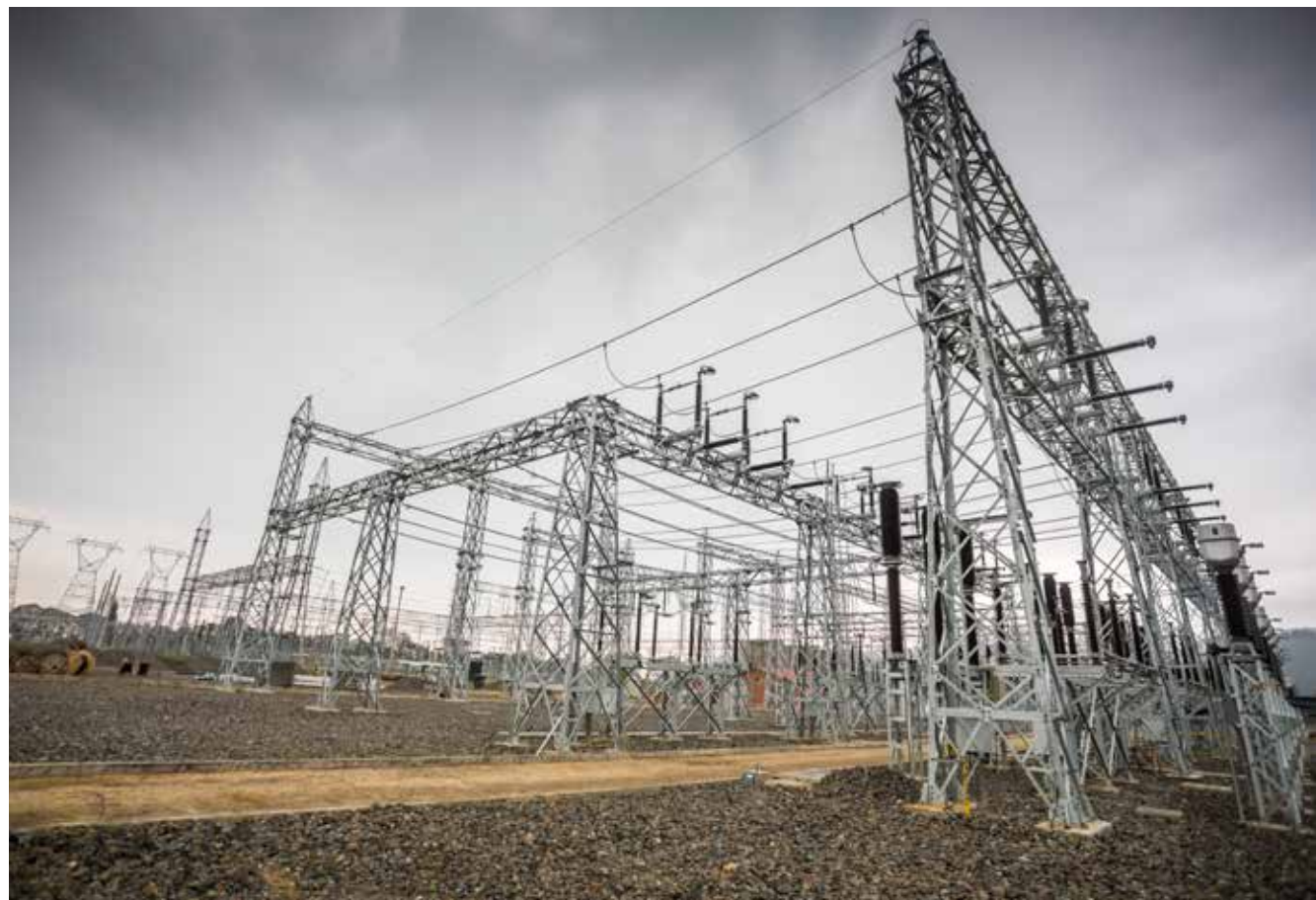
Subestación Nueva Esperanza
