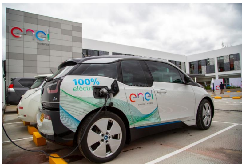
Fotos punto de recarga para vehículos eléctricos de Enel-Codensa en Chía
