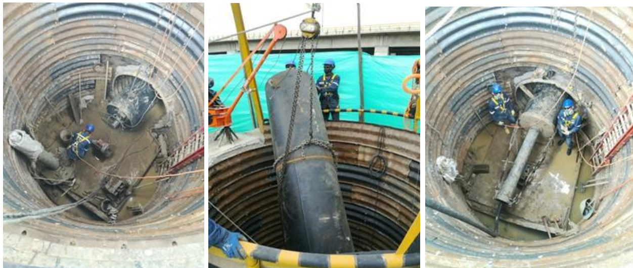
Fotografías de tecnología “ramming” para nuevo circuito que beneficiará a Madrid y Mosquera
