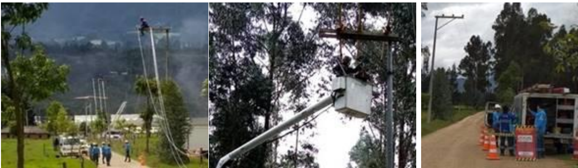
Fotografías de la construcción de 800 metros nuevos de red de media tensión
