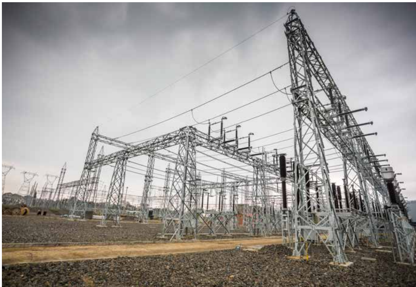
Subestación Nueva Esperanza
