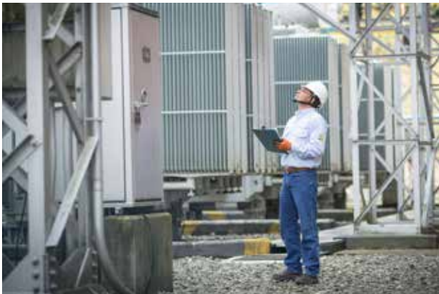
Subestación Nueva Esperanza
