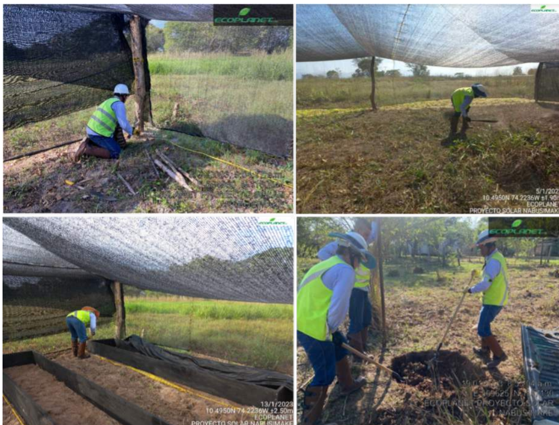
Fotos. Construcción y adecuación del vivero forestal de brinzales para el Proyecto Solar Fundación
